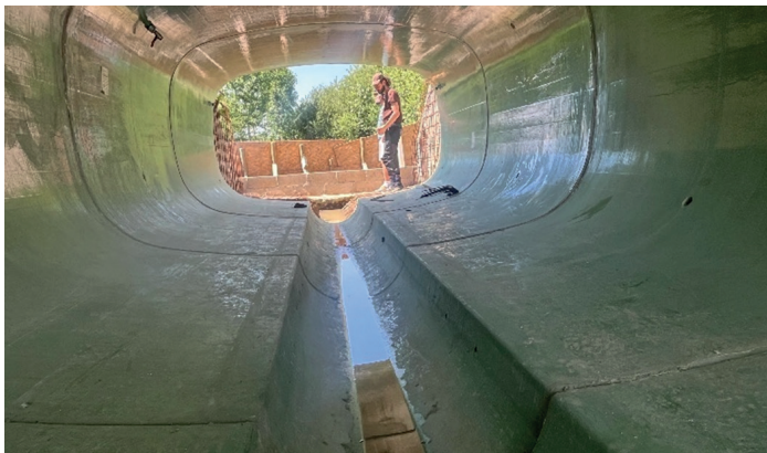
Coque en résine et cunette centrale pour le passage des poissons Source FDAAPPMA51
